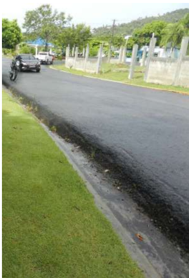
Imagen I. 11. Contén y acumulación de capas asfálticas en Samaná
