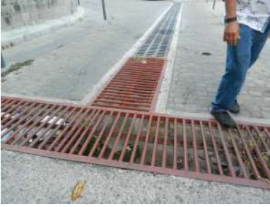
Imagen IV. 29. Drenaje central continuo
